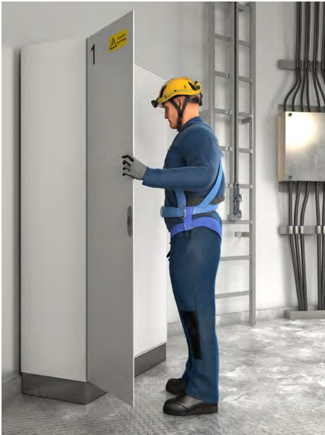
Abb. A12-1 Schaltschrank
