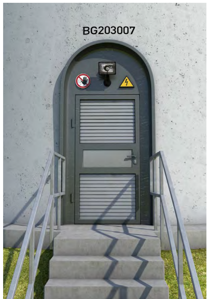
Abb. A13-7 Kennzeichnung WEA (Anlagennummer)
